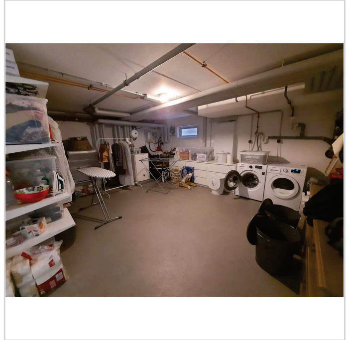
Keller Heizung Waschen
